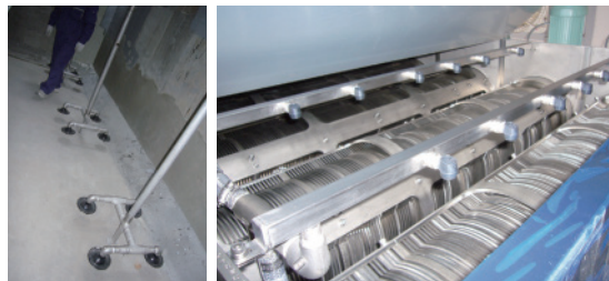
ニップンエンジニアリング(株)が施工した廃水処理設備プラント
